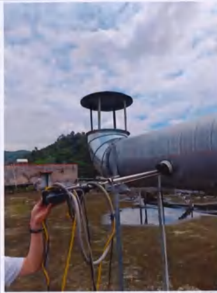
DA002 废气处理后检测口
